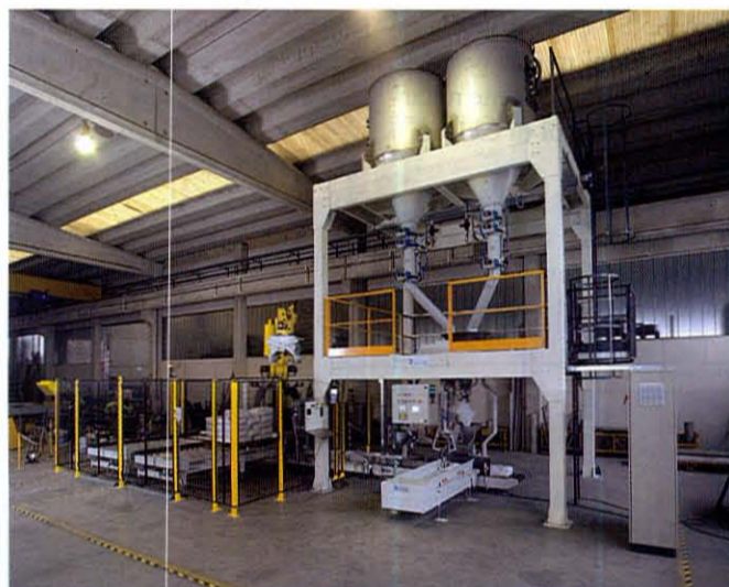
Impianto di fine linea
